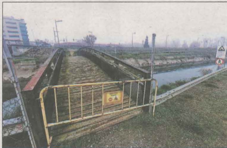
FOTO: Tony Alcántara / La pasarela, cerrada con una valla
